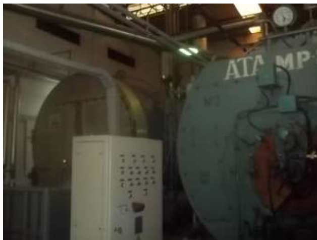
FOTO 46: Vista das caldeiras.
