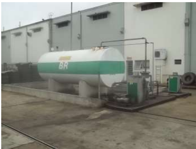
FOTO 91: Vista do tanque de combustível para abastecimento da frota própria.
