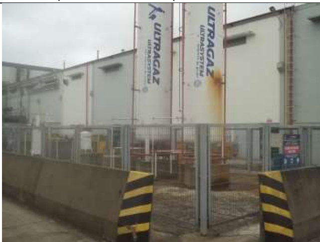
FOTO 92: Vista dos cilindros de gás para o abastecimento da fábrica.
